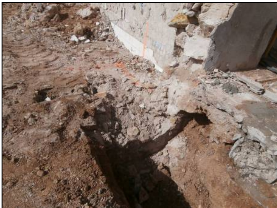
Fotografia 34: Trencament de la riosta feta amb morter de calç de la part enderrocada de l'Edifici B durant l'excavació d'una riosta.
