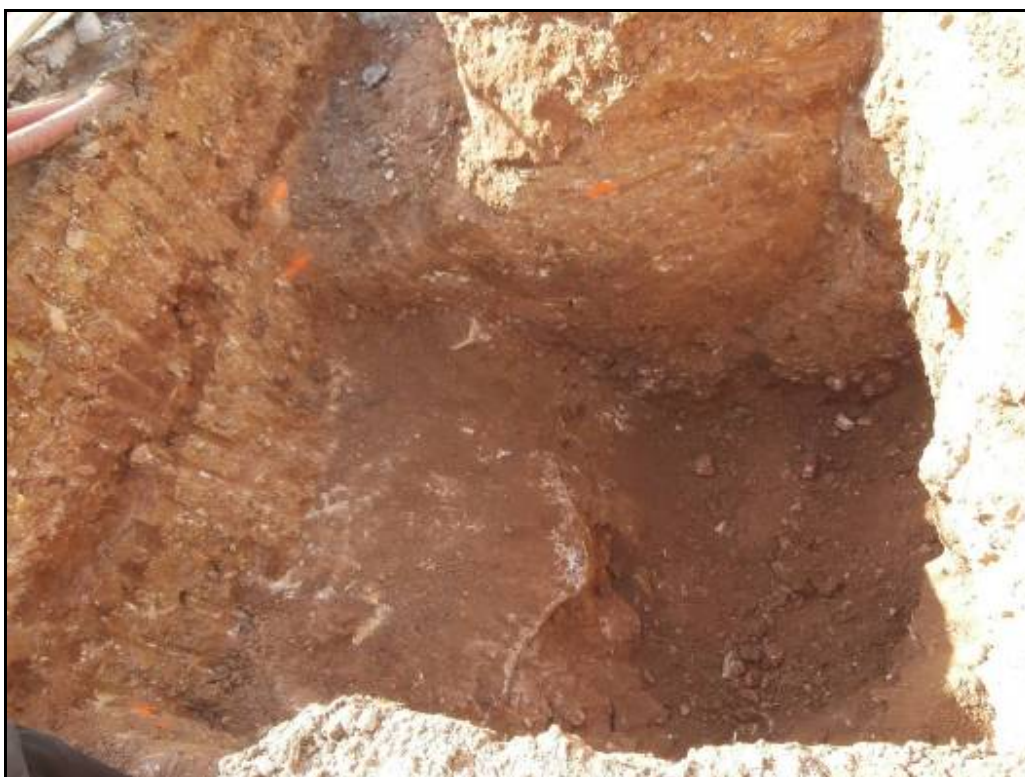
Fotografia 20: Forat de l'ascensor B, amb una roca calcària de grans dimensions.
